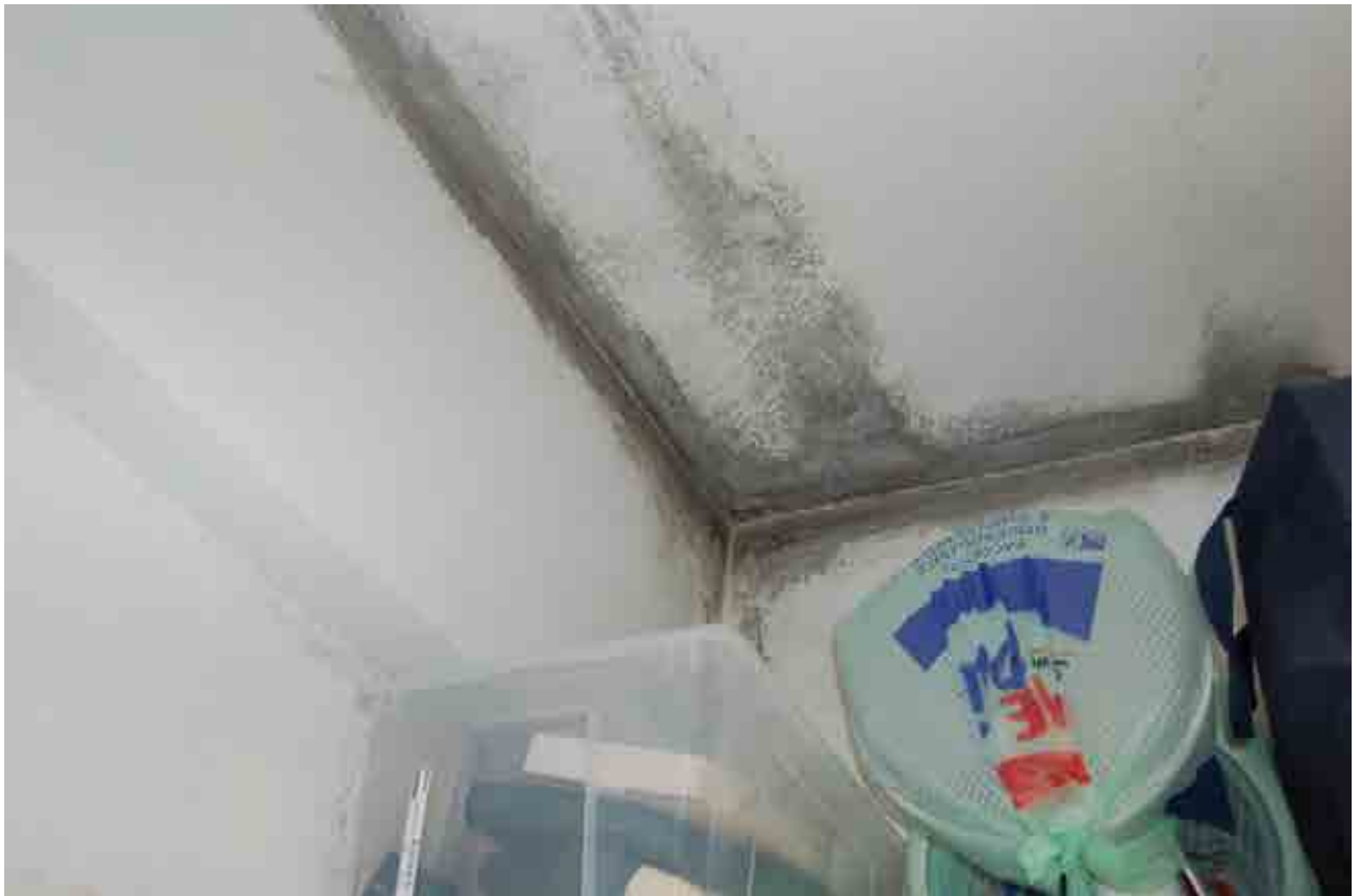
Foto 83 - Dettaglio soffitto lavanderia
