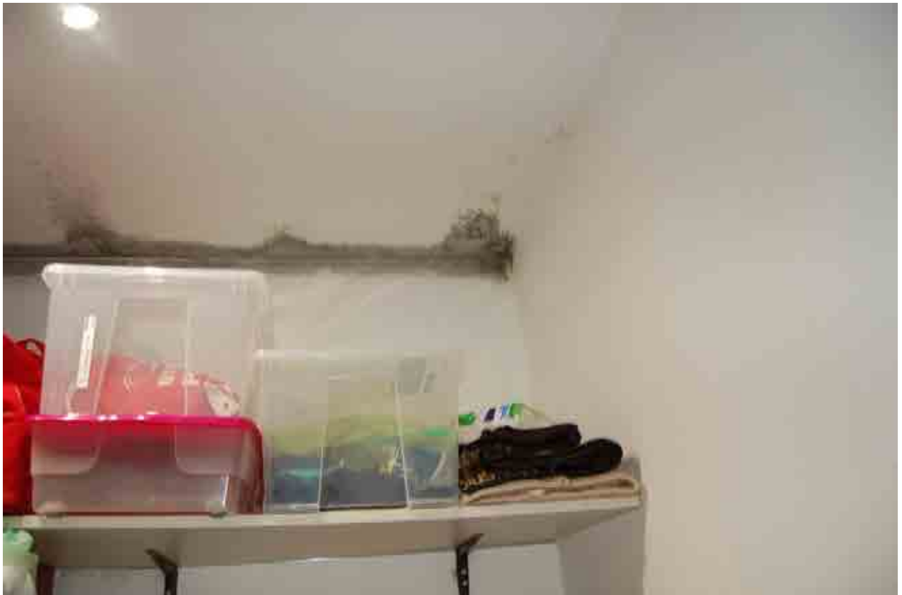
Foto 84 - Dettaglio soffitto lavanderia
